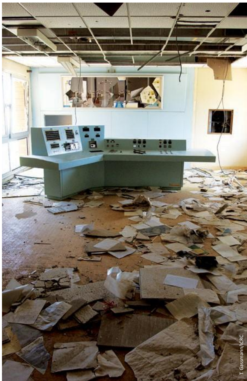
Фотография 2. Разграбленный и покинутый зал управления водоочистной станции – угроза прекращения водоснабжения для десятков тысяч жителей (г. Багдад, Ирак, 2003 г.)
